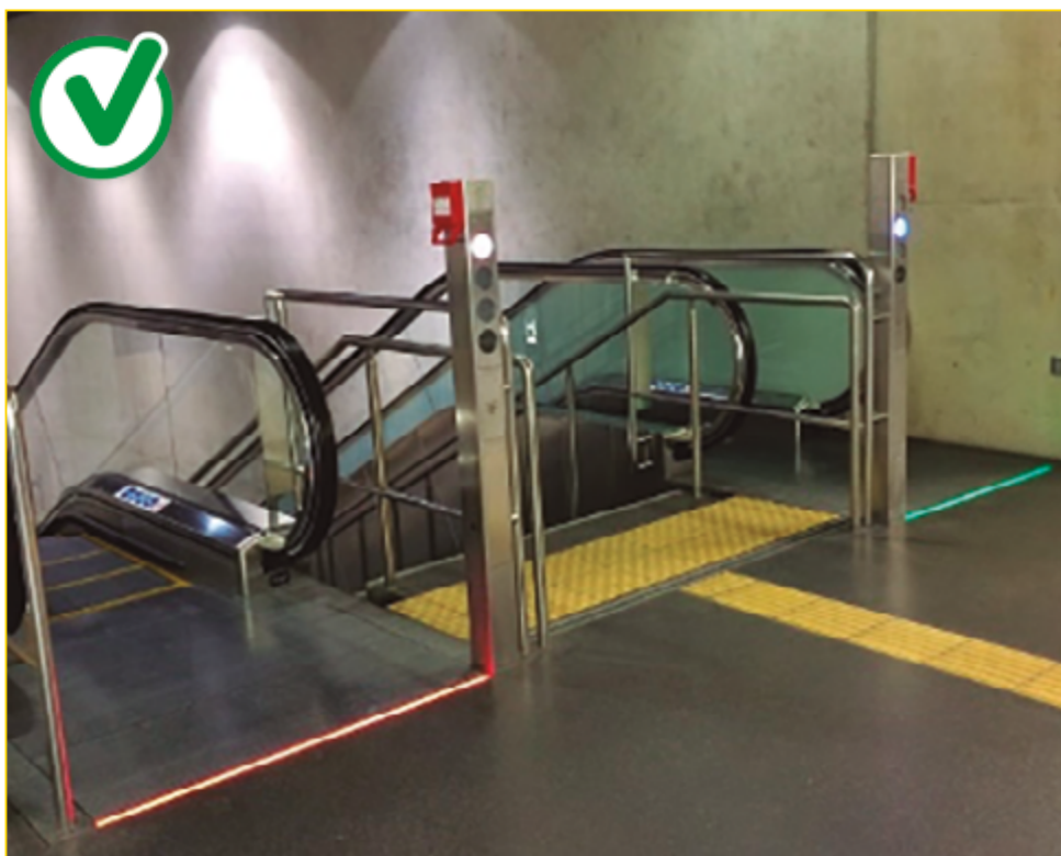
Imagen 12. Correcta señalización en el pavimento para anticipar la escalera (franja-guía ocupando todo su ancho, encastrada y con buen contraste). Correcta señalización lumínica en el embarque y desembarque de las escaleras.
