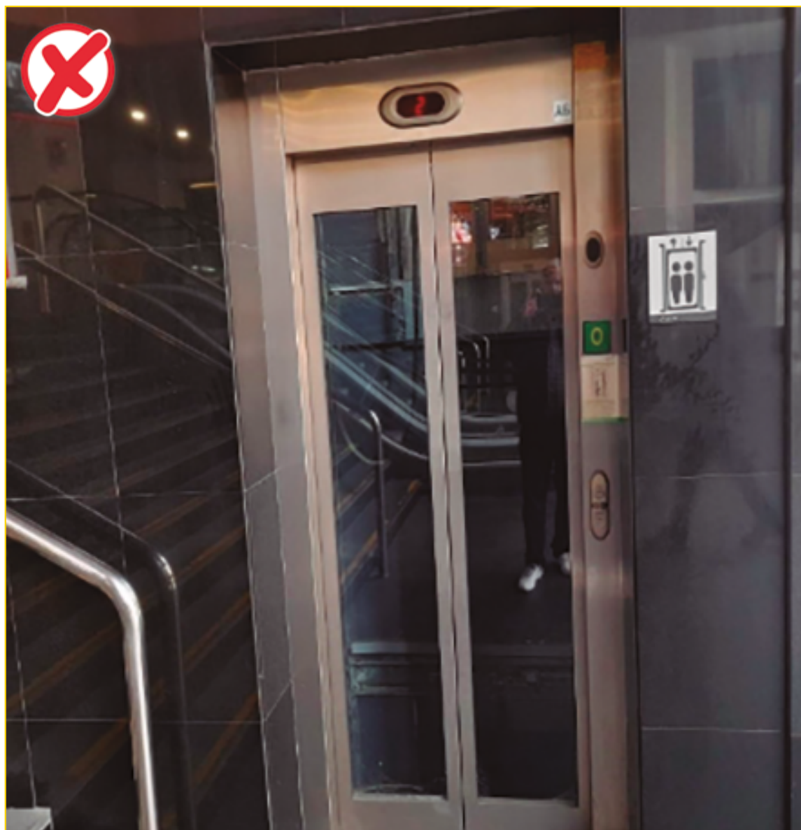
Imagen 13. Escaso contraste entre el ascensor y su paramento, botonera mal contrastada. Ascensor ubicado adyacente a los pies de una escalera, dificultando el paso tanto a los usuarios que utilizan la escalera como a los que utilizan el ascensor.
