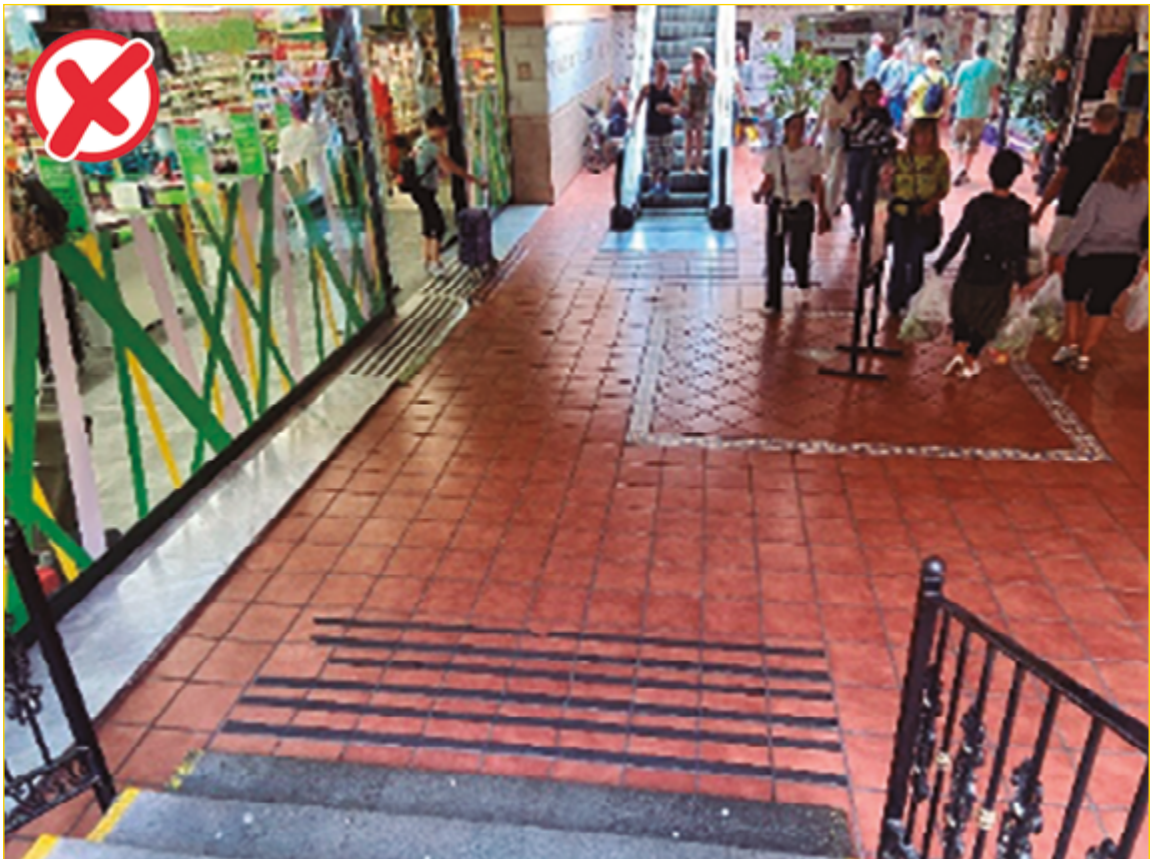
Imagen 10. Diferentes itinerarios no conectados con franja de pavimento tacto-visual. Escaleras mal señalizadas y adhesivos antideslizantes en mal estado.
