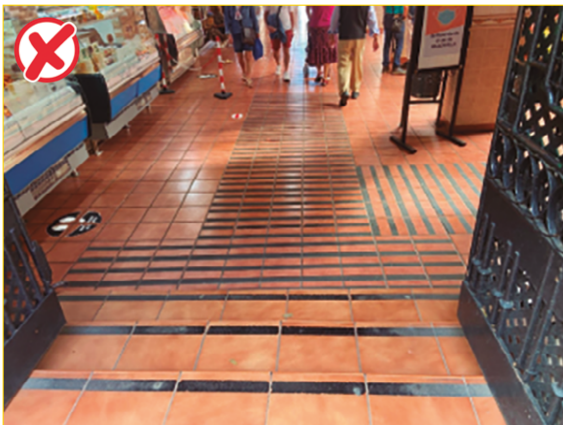
Imagen 30. Escaleras difícilmente detectables, las cintas adhesivas generan confusión entre la cota cero y los peldaños de la entrada.
